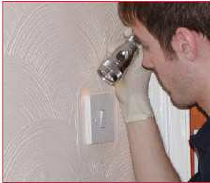
Inspección de enchufes, teniendo incluso que desmontarlos
