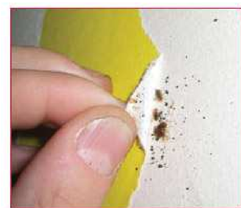
Inspección debajo de papel de pared despegado
